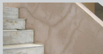
สีเป็นคราบเกลือ (Efflorescence)
