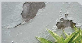
สีลอก่อน (Peeling)
